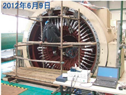
南阳电厂 200MW 发电机端部
